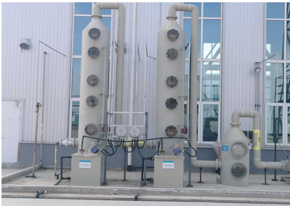
废气处理设施
