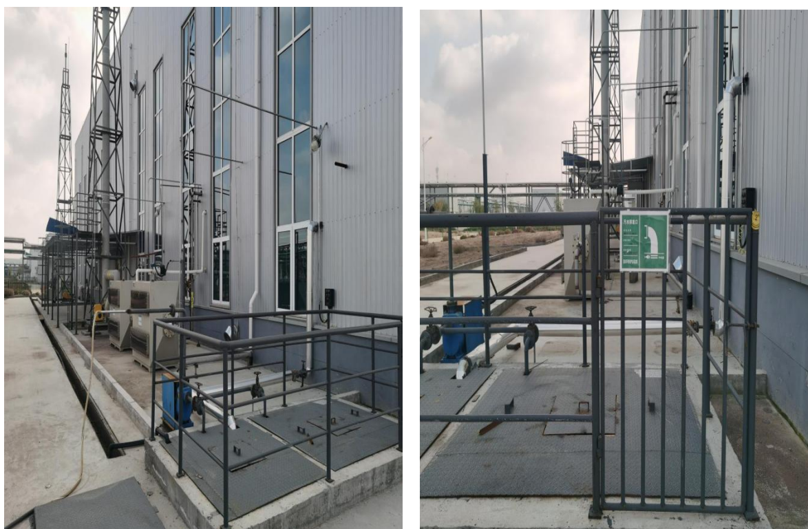
废水处理设施
