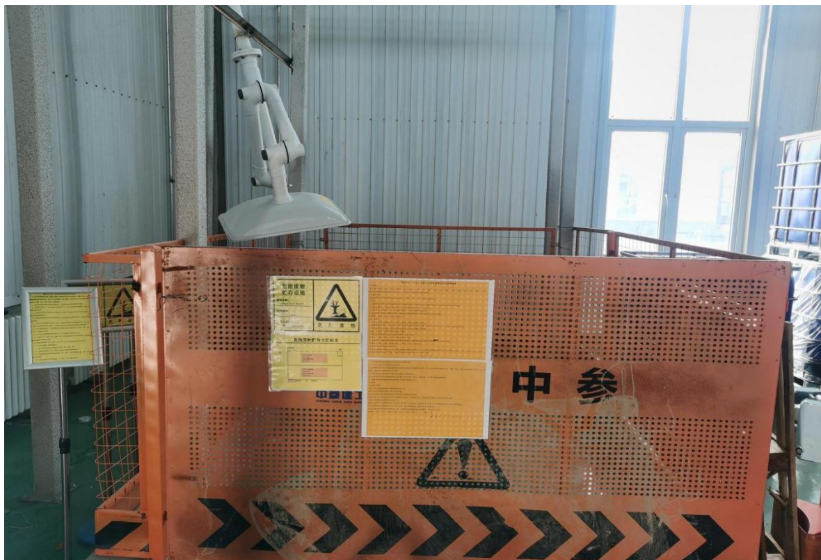
危险废物暂存点废气收集设施
