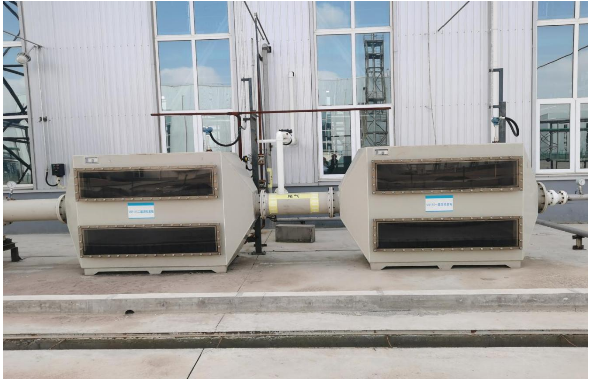
废气处理设施-活性炭吸附
